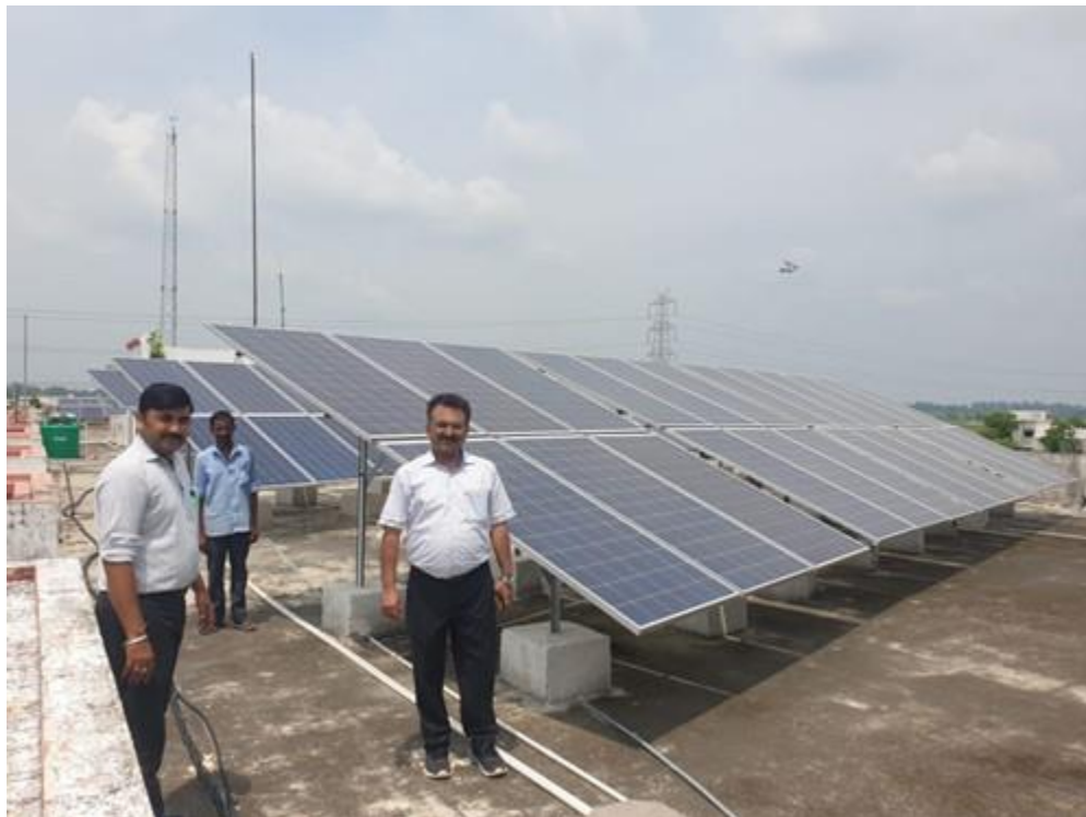
Solar Panels in ITI Barabanki
